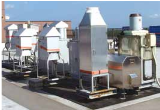
大気中の物質や降雨・降雪などを採取するための装置群 (環境研建屋屋上)
